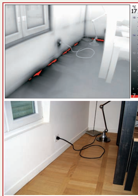
Figure 29 – Infiltrations le long d'une plinthe dans un appartement dont le permis de construire engage la RT 2000, mais commercialisé neuf en 2011
