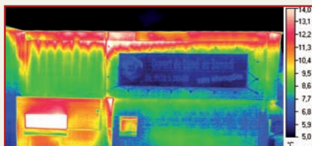
Figure 27 – Exfiltrations de la toiture d'un supermarché
